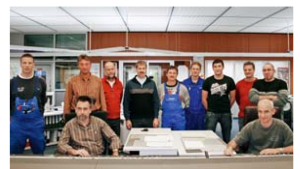
Kernkraftwerke sichern Arbeitsplätze – hier in der Warte einer Anlage in Bayern.
